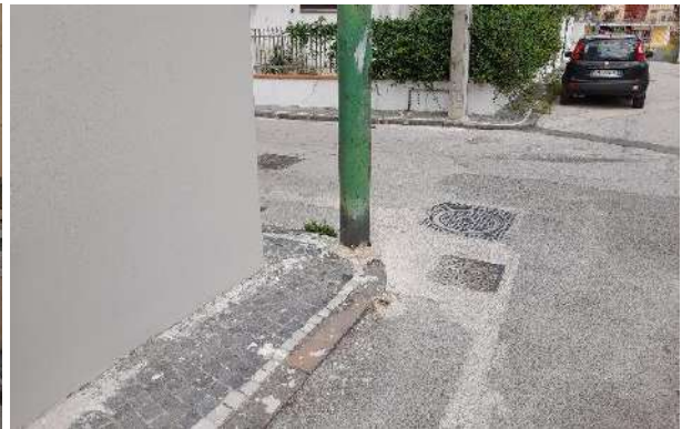
b. Via Levi (passaggio ostruito)
