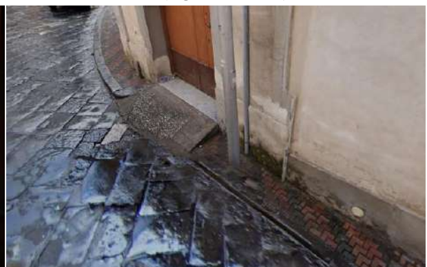
d. Corso Garibaldi (passaggio ostruito)
